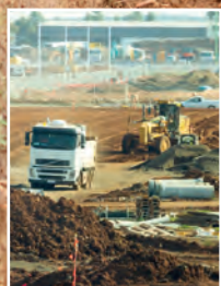
Massive Verdichtung durch Baufahrzeuge
